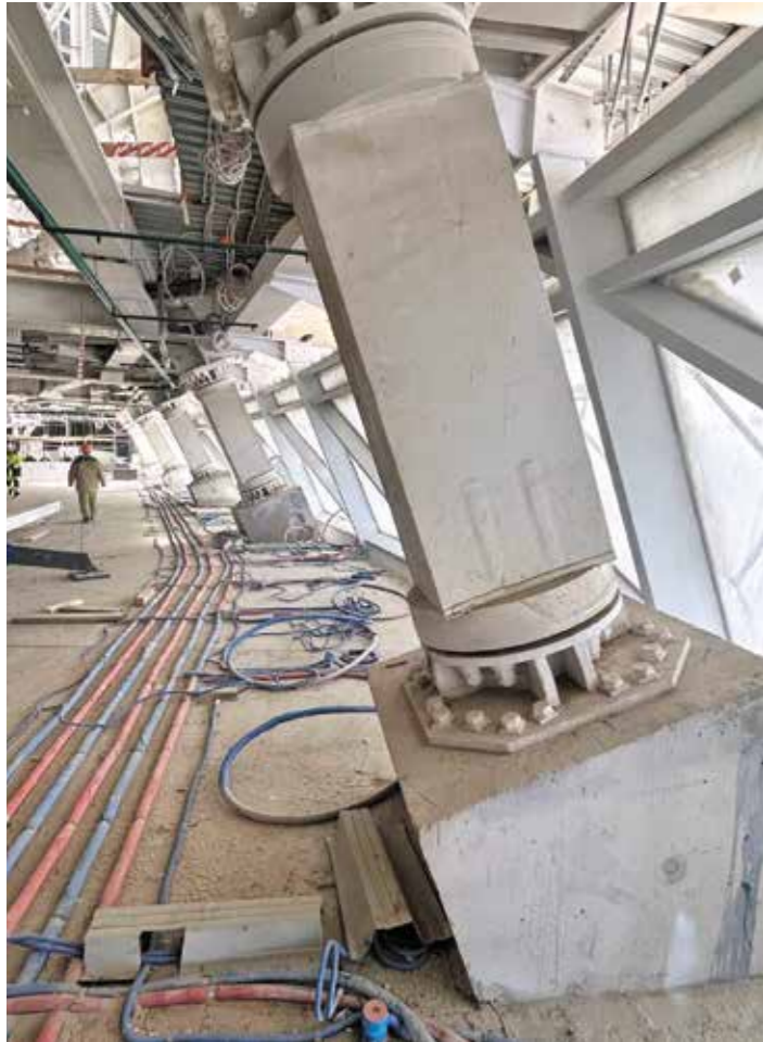
Сдвоенная опорная часть в здании Театра оперы и балета в Севастополе
