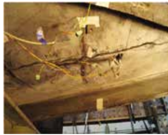
Распределение трещин в нижней части плиты
